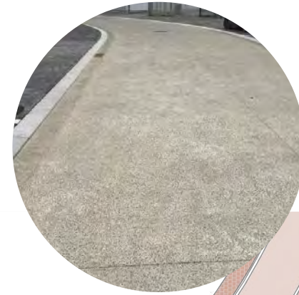
RIJWEG UITGEWASSEN BETON
